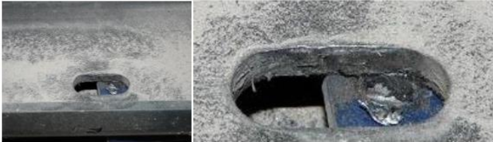
شکل (۵): تخریب پیچ به دلیل انتخاب پیچ نادرست، تحت تأثیر نیروهای برشی زلزله
